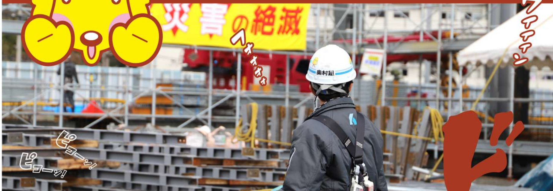
▲画像：(株)奥村組の建設作業員さん(新病院建設現場にて) ▲イラスト：マスコットキャラクター「ハッピー」
