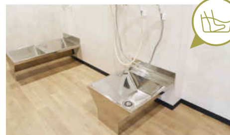
▲ 2. フットケアに特化した設備 (写真は2階透析室)
